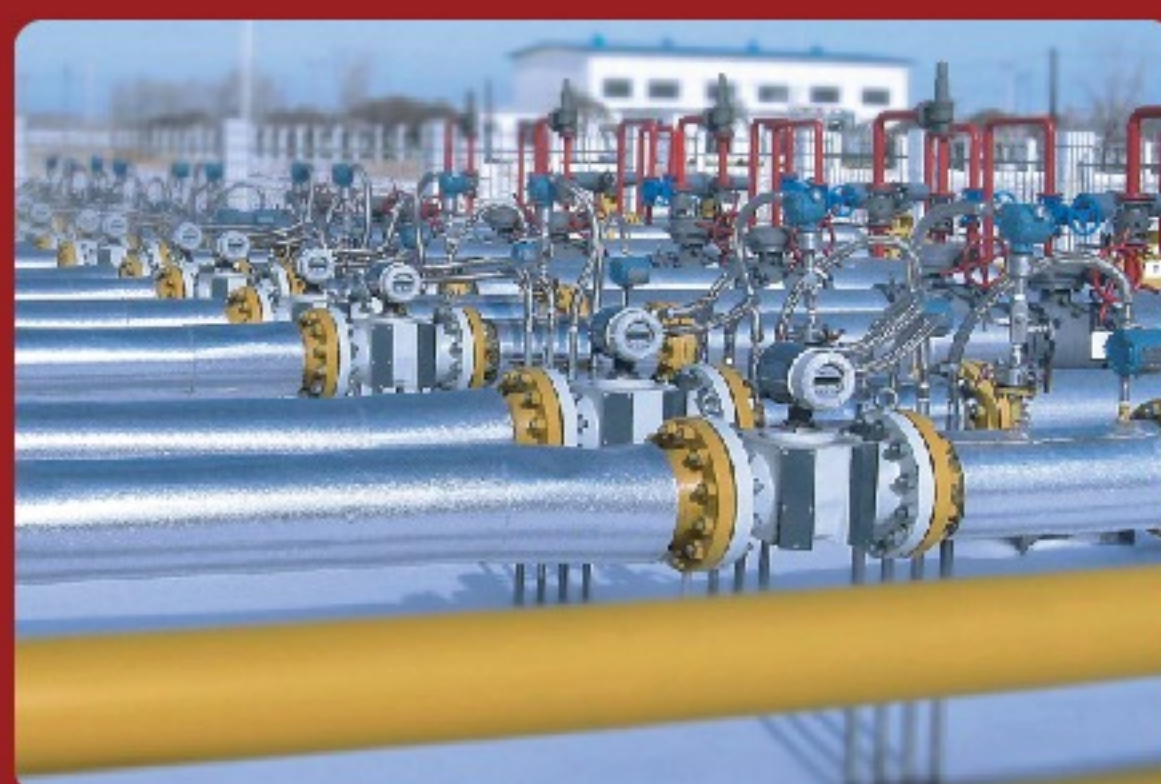
Hệ thống đo lưu lượng khí gas trong ngành công nghiệp dầu khí (Flowmeter system for gas in oil)
