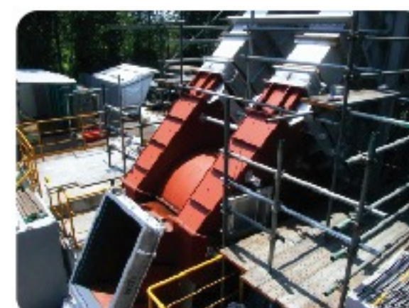
Quạt hút thu hồi bụi (Dust collector exhaust fan)
