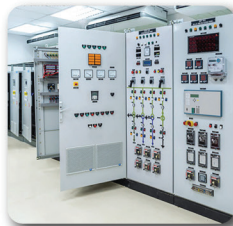
Tủ điện công nghiệp
